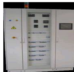
TGBT – Travaux pratiques Systèmes communicants
